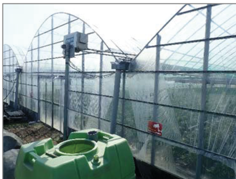
防犯カメラの設置
