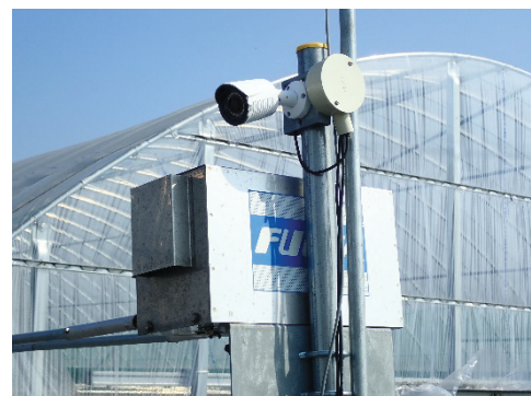
防犯カメラの設置
