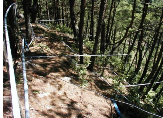
写真-5 揚水タンク・塩ビパイプを利用した 広範囲な散水方式の一例(諏訪市)
