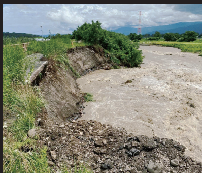
今年7月に発生した豪雨の影響で 奈良井川の護岸が崩壊。
