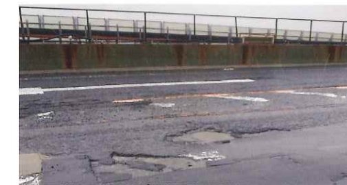
補修が必要な現状の路面
