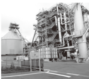
木質バイオマス発電所
