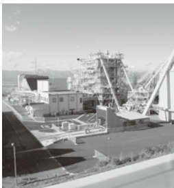
木質バイオマス発電所
