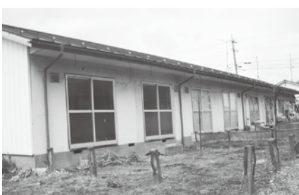
老朽化が進む市営住宅
