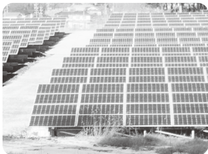
太陽光発電所
