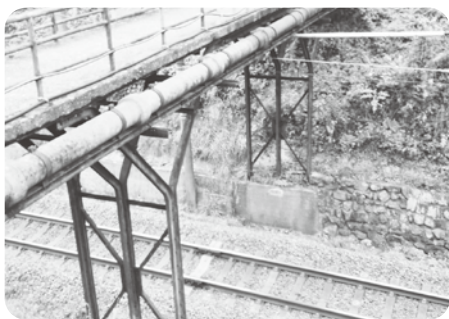
賢川人路橋 (レールでつくった橋脚は腐食が進んでいる)
