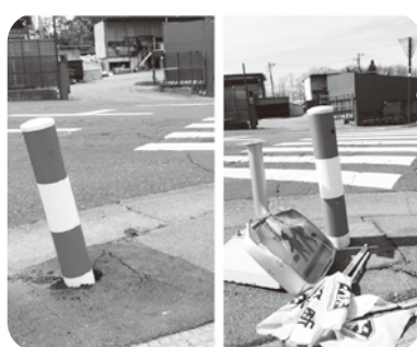
事故で壊れた横断旗ボックスと車止め
