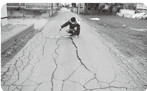
冬季凍結による市道の舗装破損
