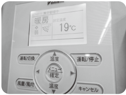
市役所本庁舎内のエアコンのコントローラー
