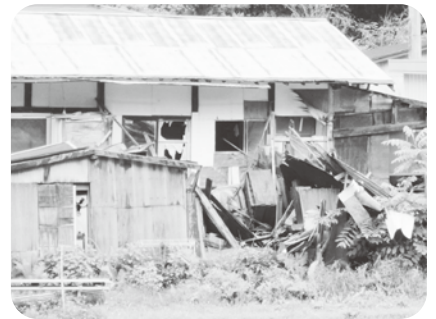
放置された空き家
