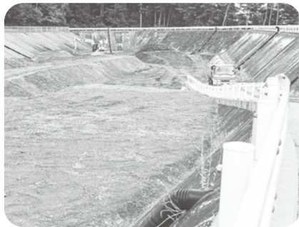
朝日村にある最終処分場 (有料ごみ袋はごみ減量に寄与しているが)
