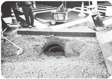
路面下空洞調査で発見された穴
