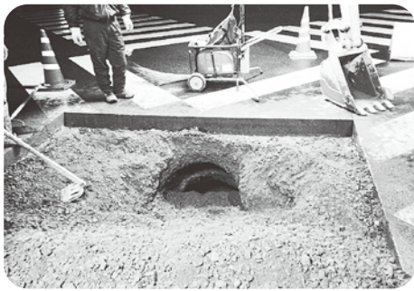
路面下空洞調査で発見された穴
