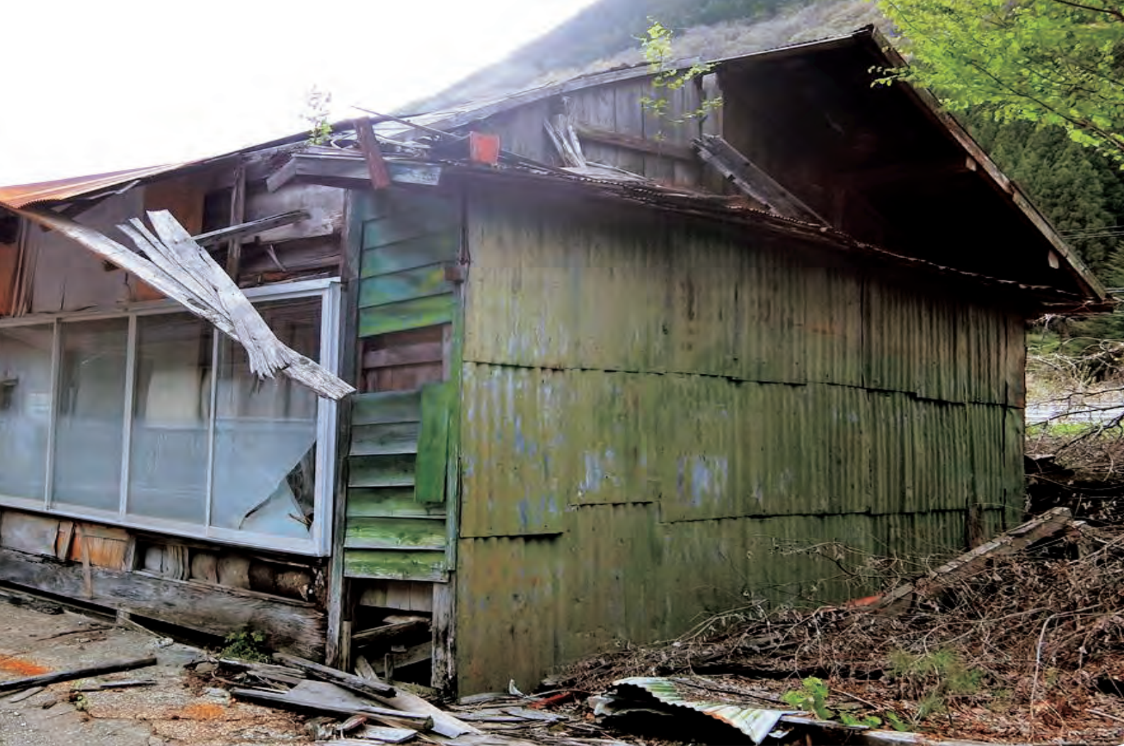
【特定空き家の例】現在は所有者により解体済みです。
