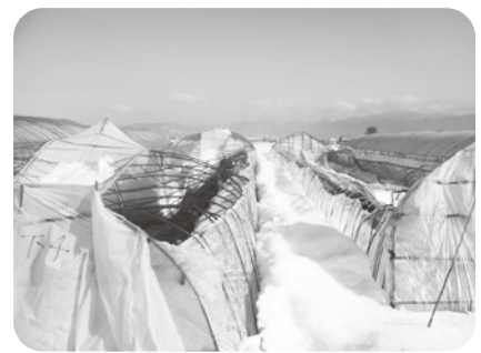
大雪で倒壊したビニールハウス
