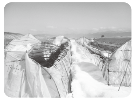
大雪で倒壊したビニールハウス
