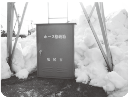
一早く除雪された消火設備
