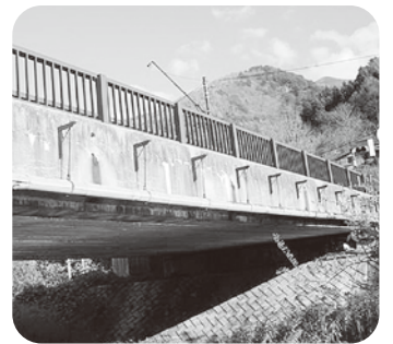
老朽化が進む橋
