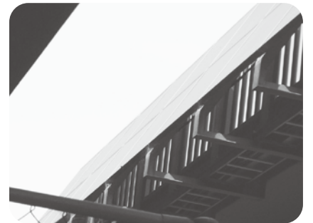
近江大橋に設置されているソーラーパネル
