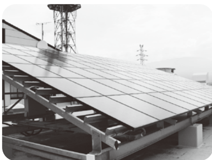
保健福祉センター屋上のソーラーパネル
