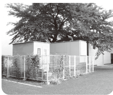
非常用発電機（保健福祉センター）
