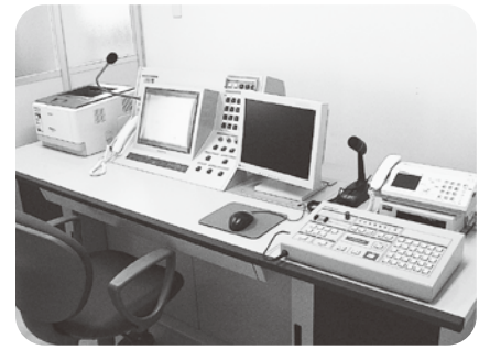
新たに設置された防災行政無線施設
