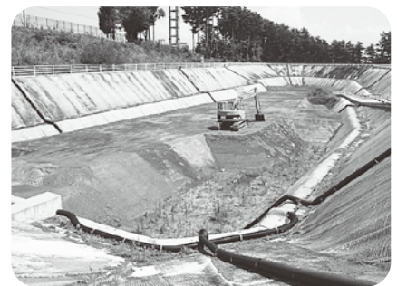
焼却灰を処理する最終処分場
