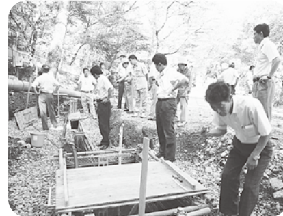
みどり湖重油漏れ箇所を視察
