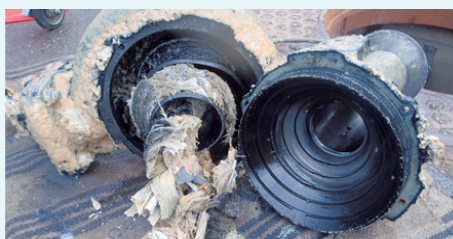
下水道ポンプの故障により、ポンプを分解した時の写真
