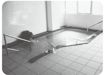
現在利用が中止されている入浴施設
