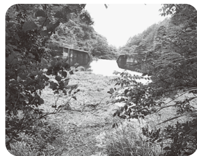
大量の土砂が堆積している 四沢川の四沢ダム
