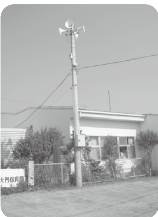
電柱に設置されたアンテナ・スピーカー
