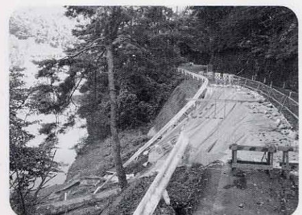
7月集中豪雨災害 被災箇所(みどり湖畔)
