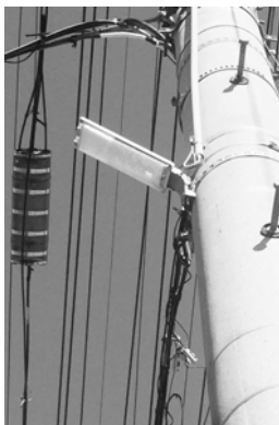
LED化された防犯灯
