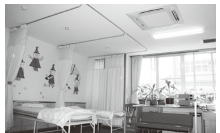
塩尻西小学校保健室の設置済みエアコン
