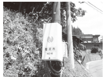
榑川地区防災行政無線の屋外子局マスト
