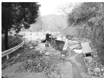
陥没が生じた市道高ボッチ線(東山ルート)
