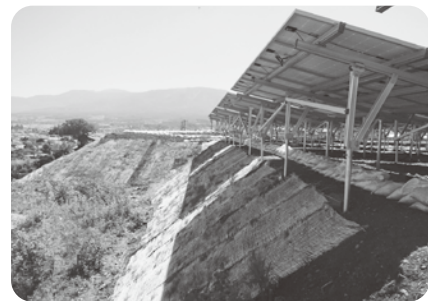
大門上ノ山に建設されたソーラーパネル
