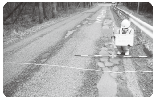
床尾平出線の舗装破損箇所
