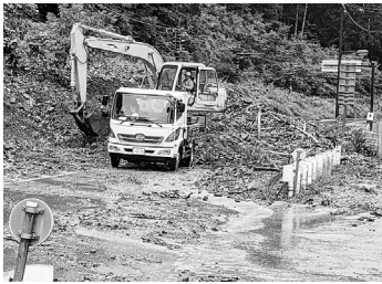
土砂崩れの大崩沢
