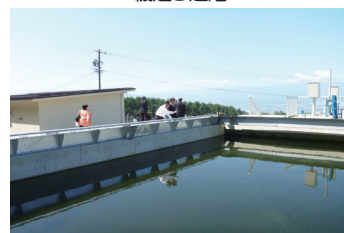
かんそく 緩速ろ過池
