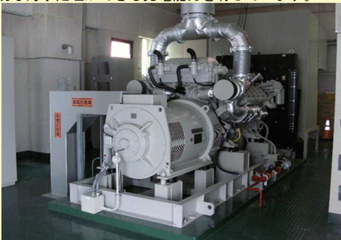
◇新しくなった発電機
