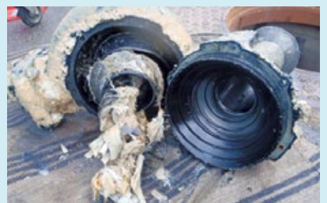
下水道ポンプの故障により、ポンプを分解した時の写真
